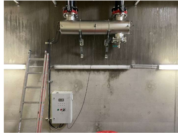
12) ULTRA V1.2k – Juni 2022, 1.200W mit 4 Strahlern zur Kühlwasserbehandlung von bis zu 80m 3 /h in einem Stahlwerk
