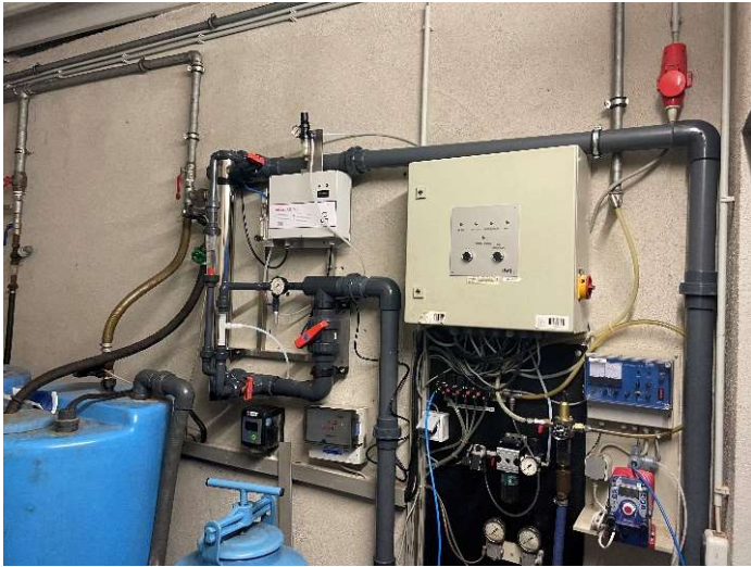
11) ULTRA V150/O3 – Installiert im März 2022 für die Desinfektion von Kreislaufwasser eine Waschanlage für LKW und Züge in einer Ausführung mit verstärkter Ozoninjektion
